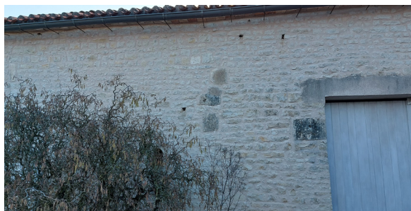
Trous dans les murs en moellons
